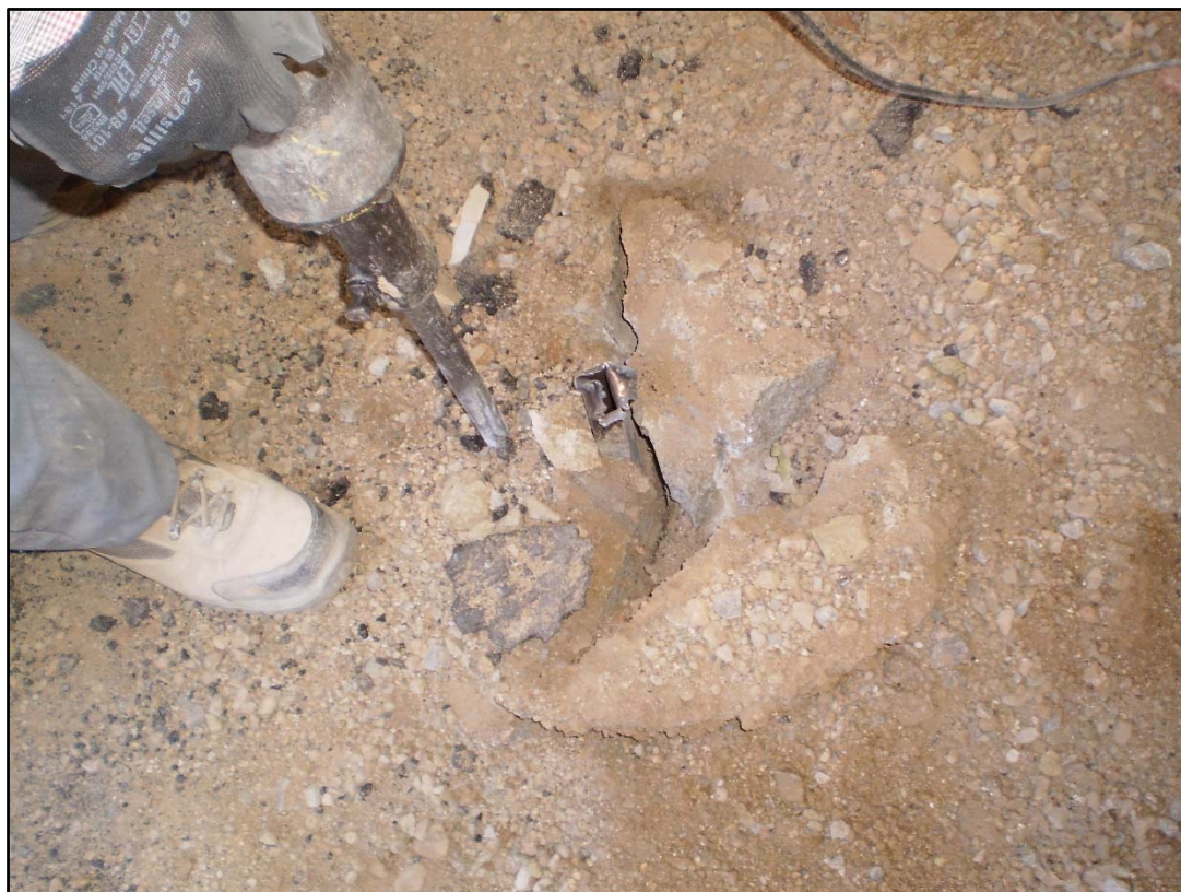
Destrucció de l'encoratge lateral del torn zona2.
